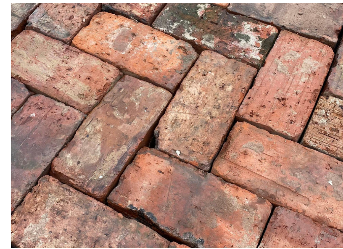
Bontott téglaburkolat, nyílthézagos
